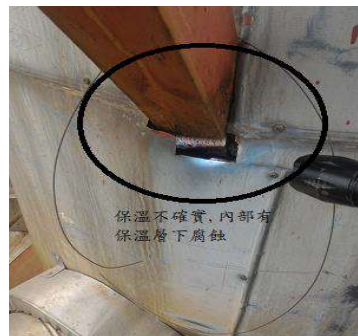
保溫層下腐蝕
