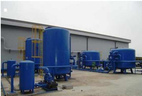
食品及工業用水處理設備 水資源回收處理設備 規劃、製造、安裝工程
