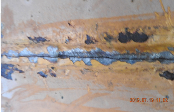
圖1 固定式起重機桁架底板裂縫處
