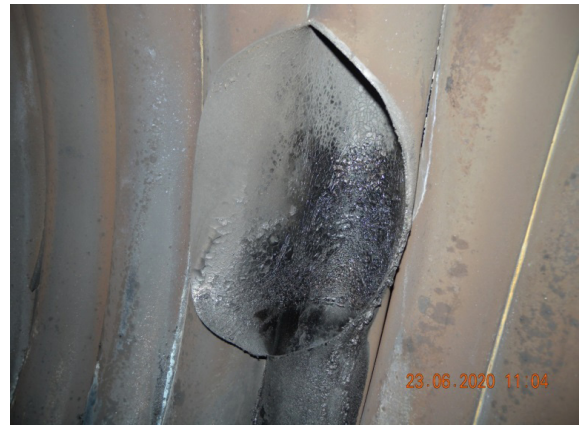
燃燒室內輻射區加熱內盤管(STB340)爆破口，屬塑性變形。
