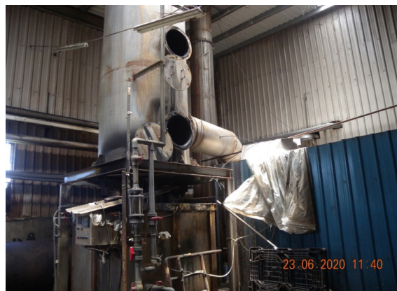
部分燃燒爆炸氣體向煙氣出口之洗煙塔(煙囪)排放。
