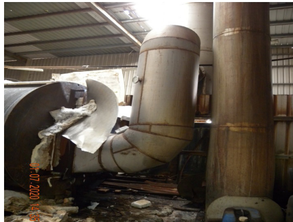
鍋爐排煙出口改接洗煙塔(左側配管)。煙道防爆門位於3迴路煙氣出口處下方，未及作動。
