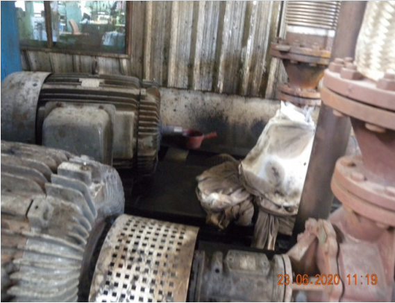
熱媒油循環泵拆除備用機台，如現役之循環泵發生機械故障，將使鍋爐陷入封閉悶燒爐管脹破之立即危害。
