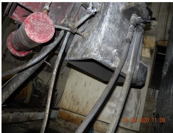
燃燒室爐管破裂，沸騰熱媒蒸汽噴出發生燃爆，暴風從燃燒機之空氣吸入口處噴出。
