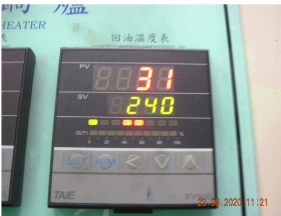
鍋爐熱媒油回油溫度控制指示。
