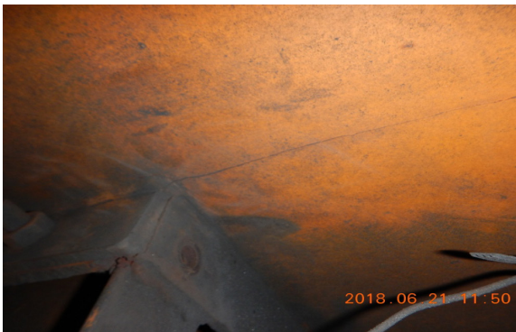
圖3 固定式起重機桁架及鞍架接合處裂縫
