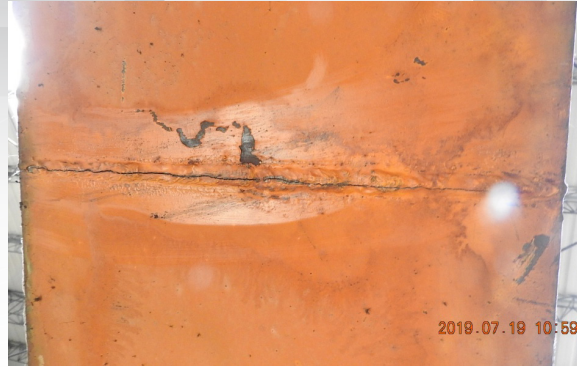
圖2 固定式起重機桁架底板裂縫處
