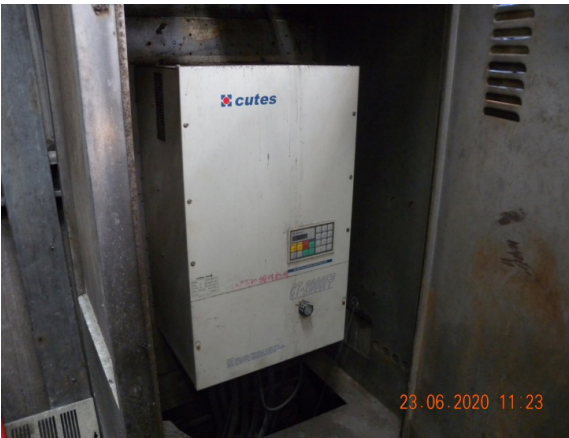
熱媒油循環泵之馬達電源加設變頻器，調降電壓頻率(220V, 0~60Hz可調)，降低熱媒油循環速率。
