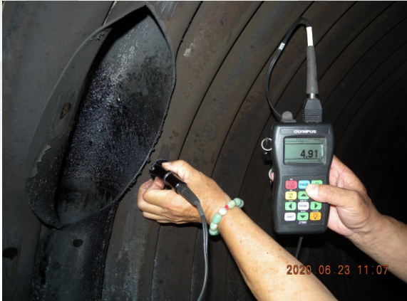
內盤爐管管壁測厚值4.9 mm (原製造厚度4.5mm)。
