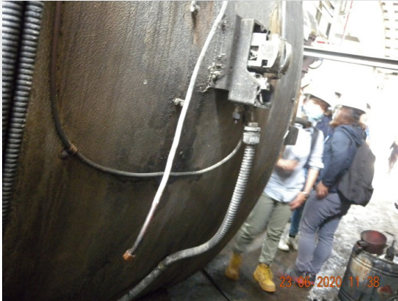
鍋爐原設熱煤油低流量保護裝置--差壓計，其出口壓力連接管拆除，失卻重要的防護機能。
