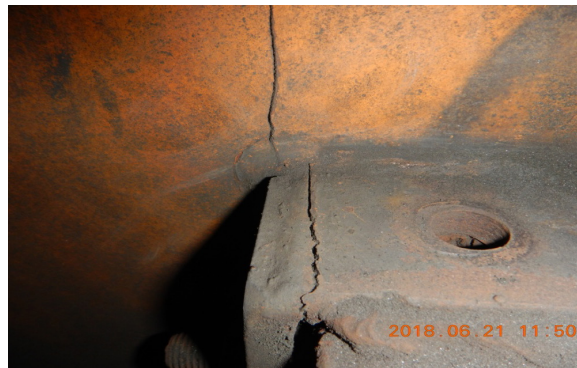
圖4 固定式起重機桁架及鞍架接合處裂縫處
