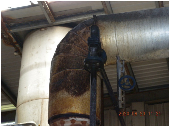
爐膛燃燒爆炸瞬間能量釋放，安全閥位於外管圈熱煤油出口管路，未及作動。
