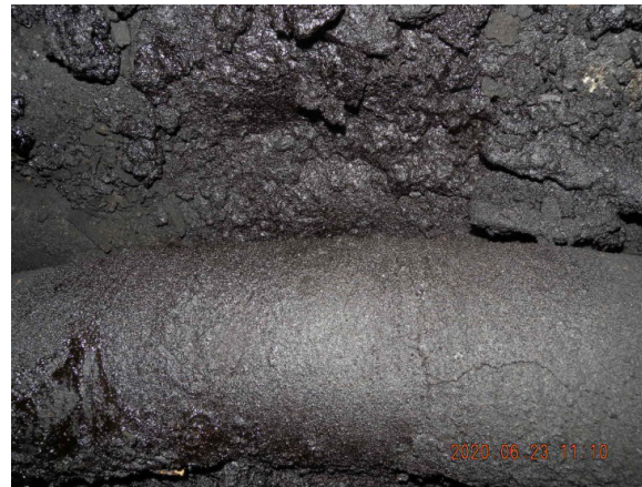
內盤爐管內壁因高溫形成油碳垢結渣堆積，於爆破後排出。
