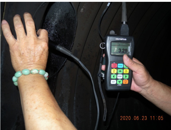
內盤管爆破口處側邊管壁測厚值3.2mm(原製造厚度4.5mm)。
