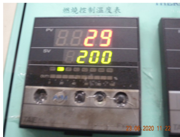
鍋爐熱媒油回油溫度控制指示。
